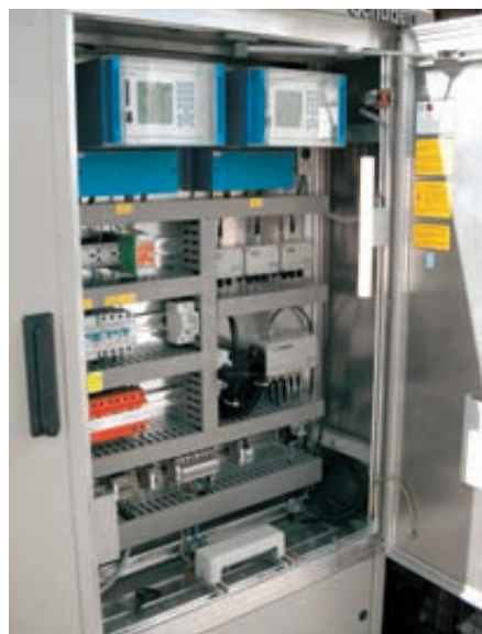
In einem Schaltschrank kann das Telemetriegerät vor Ort eingebunden werden. Dieses Bild zeigt eine Pumpensteuerung mit Überwachung in einer Abwasseranlage.
