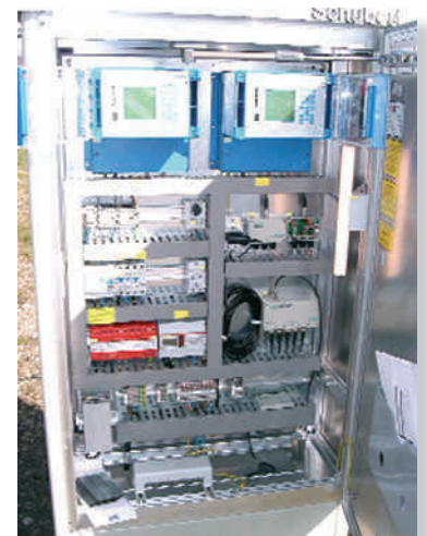
Bild 2: In einem Schaltschrank kann das Telemetriegerät vor Ort eingebunden werden. Dieses Bild zeigt eine Pumpensteuerung mit Überwachung in einer Abwasseranlage.
